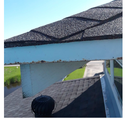
Rusting roof edge
