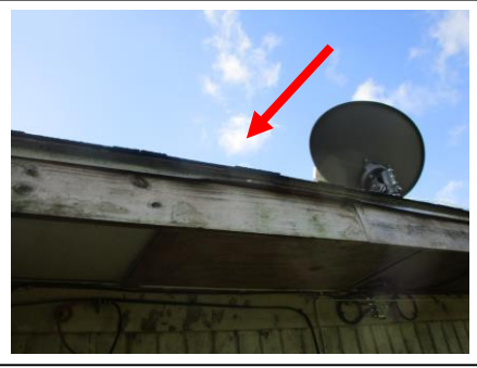
Loose Metal Edge Flashing
