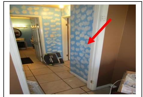
Missing Bedroom Door
