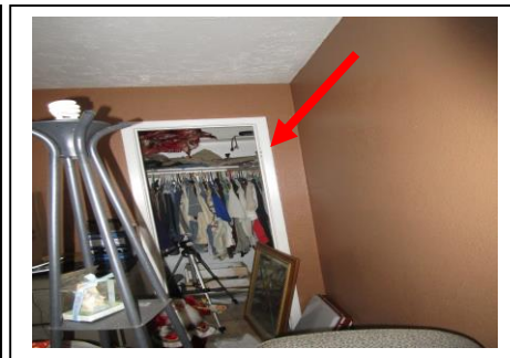
Missing Bedroom Closet Door
