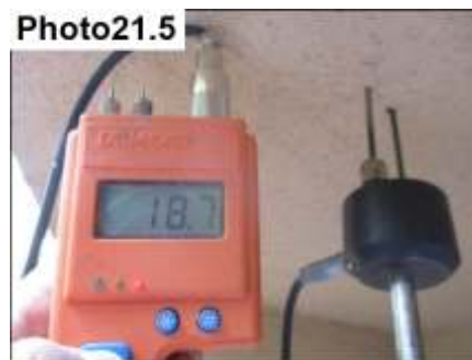
Moisture Probe/ Bottom Wall
