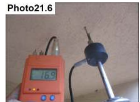
Moisture Probe/ Bottom Wall
