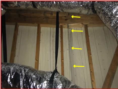
Apparent moisture intrusion
