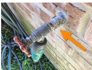
Exterior hose bibb(s)
