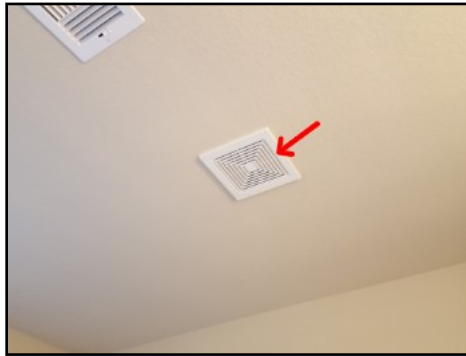
Exhaust fan not functioning
