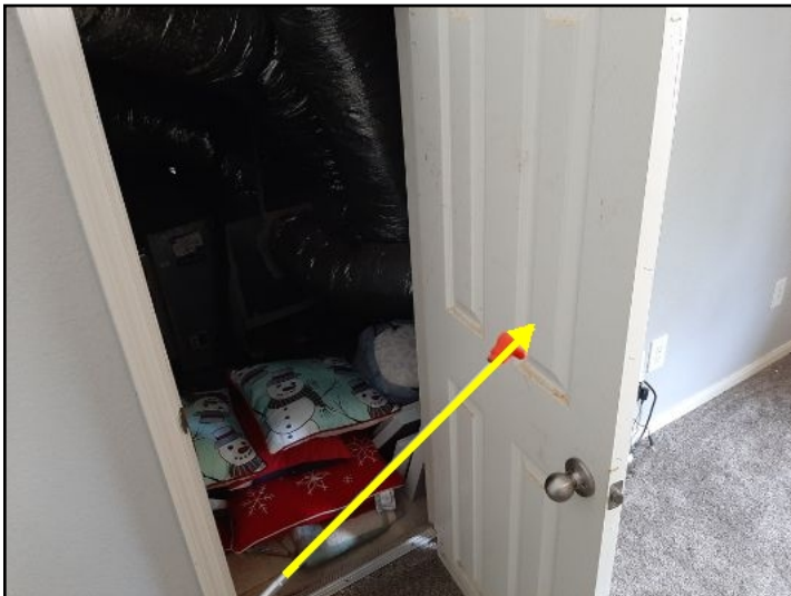
HOLLOW DOOR / NOT SAFETY DOOR
