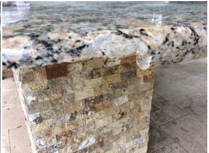
Broken countertop edge
