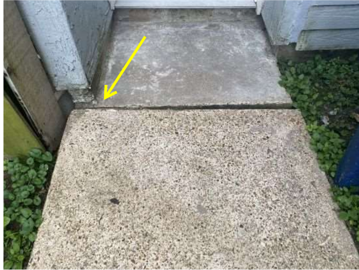
Uneven pathway - trip hazard
