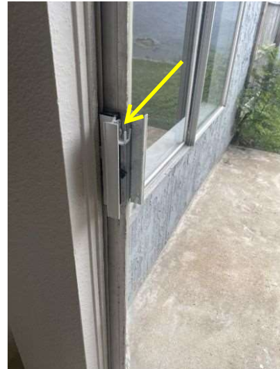
Door does not latch -patio door
