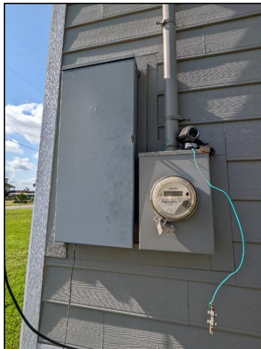
28. Breakers - exterior wall
