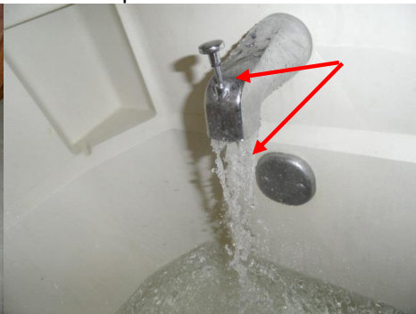
diver not functioning
