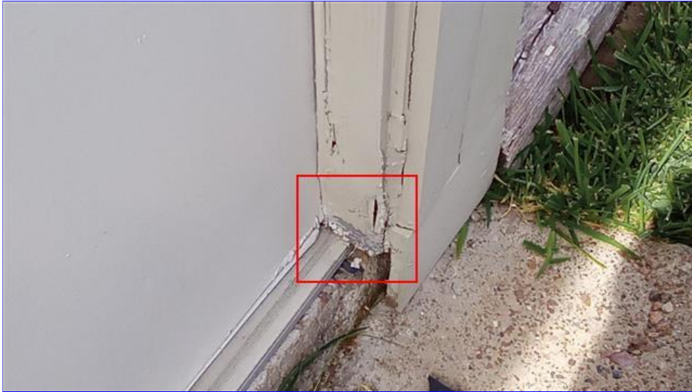
G. Item 4(Picture) right jamb
