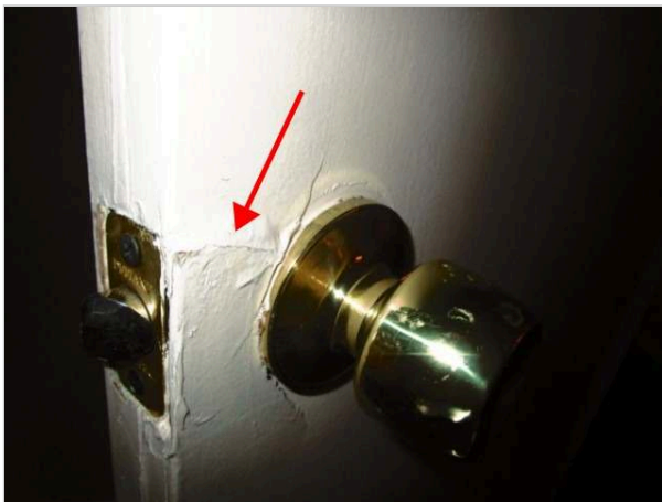
Damage - left bedroom door
