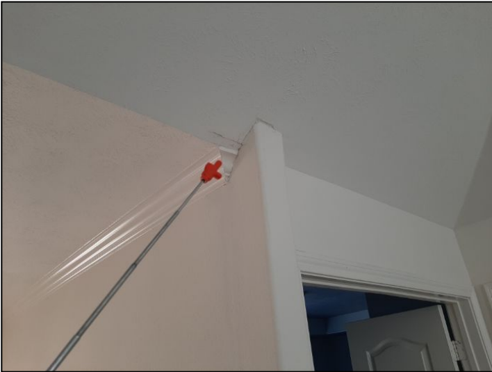
MINOR DRYWALL CRACK
