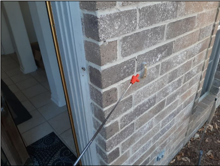
INOPERABLE DOOR BELL
