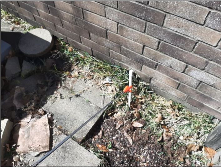
LOOSE / UNSECURED CONDUIT
