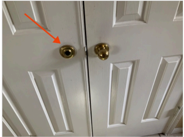
Door knob missing - pantry
