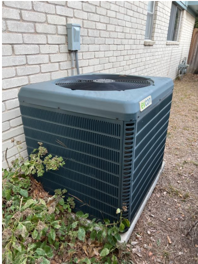
AC condensing unit.
