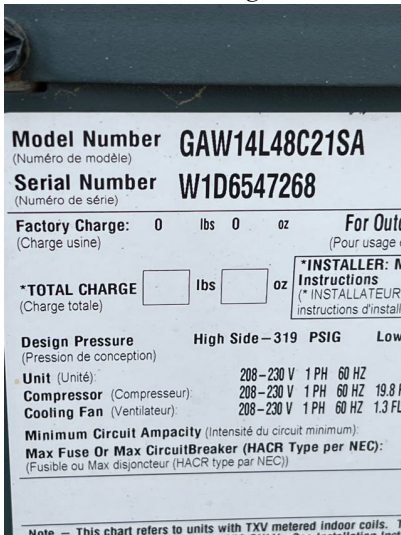
AC condensing unit data tag.
