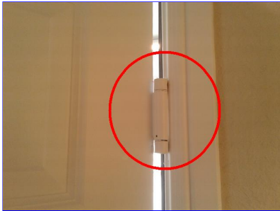
G. Item 1(Picture) garage door
