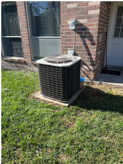
AC condensing unit.
