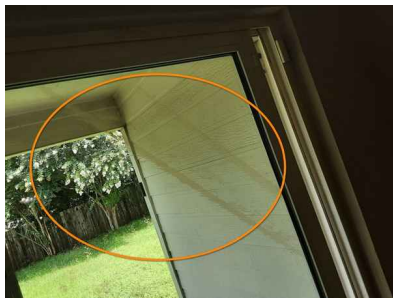
Door pain broken seal
