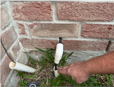
Left: Damaged conduit
