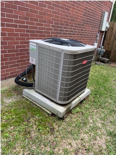
AC condensing unit.
