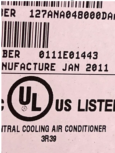
AC condensing unit data tag.
