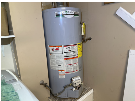
Water Heater: 2017 A. O. Smith 40 Gallons
