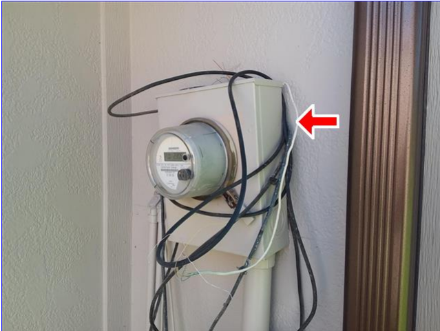
A. Item 3(Picture) meter loose
