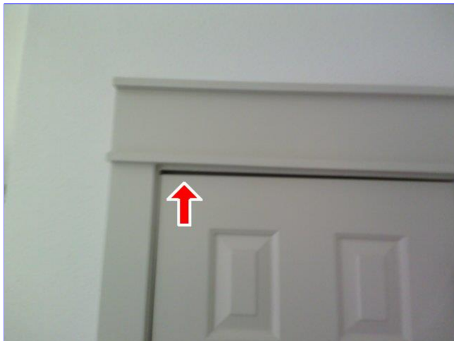
G. Item 5(Picture) stairway closet door
