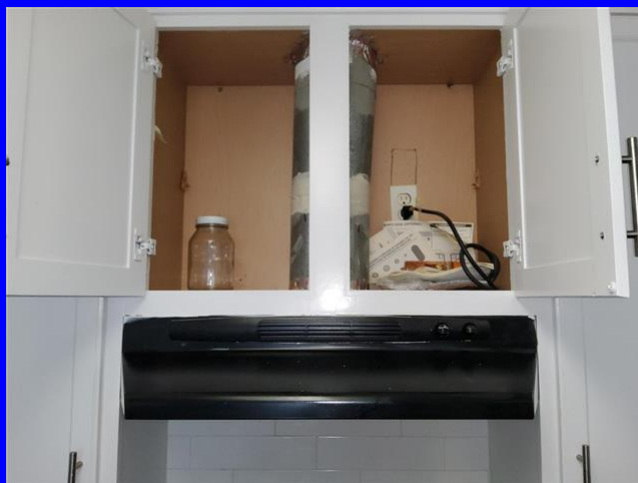
Kitchen exhaust fan
