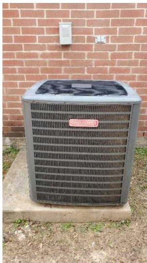
AC condensing unit.
