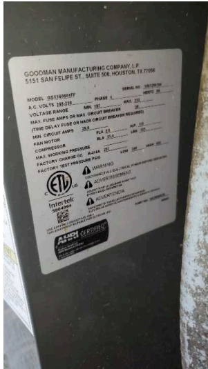
AC condensing unit data tag.
