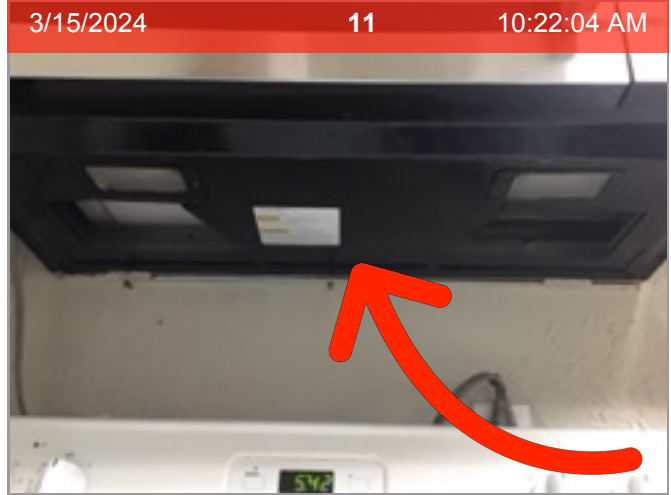
Exhaust Fan | No filters
