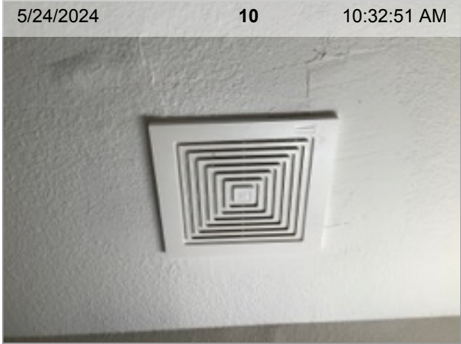
5/24/2024 10 10:32:51 AM Exhaust Fan
