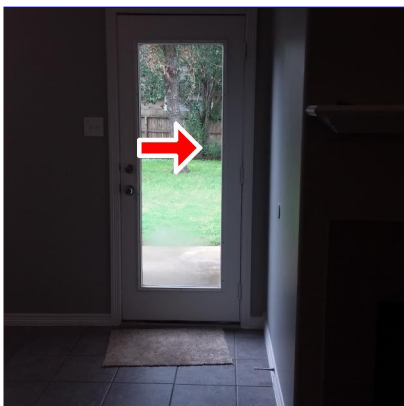
G. Item 2 (Picture) Back door
