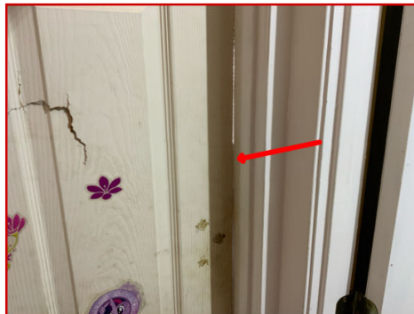
Bedroom door binds on jamb
